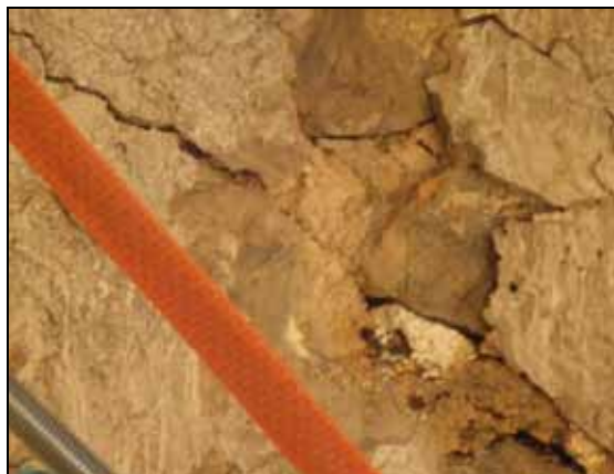
Rottura del muro con particolare della fessurazione diagonale
